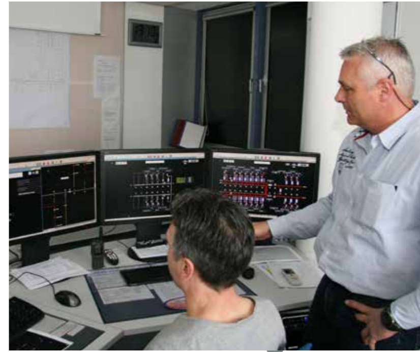
Die Stabilität des Netzes, alle Störungen und Ursachen werden in der Leitwarte erfasst.
