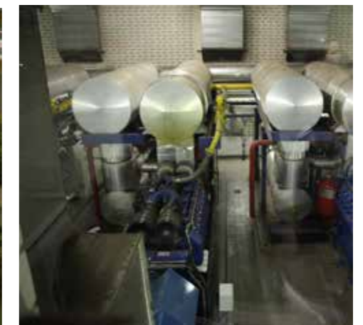
Blockheizkraftwerk 2 in Königsborn.
