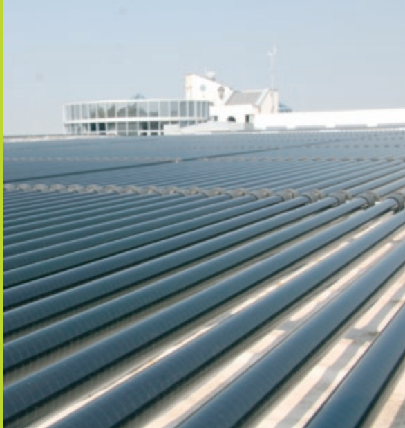
Photovoltaik-Anlage auf dem Lagergebäude der Stadtwerke.
