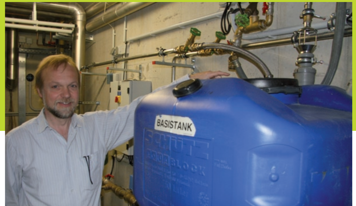
Die Regenwasseranlage in unserer Firmenzentrale spart Frischwasser ein.
