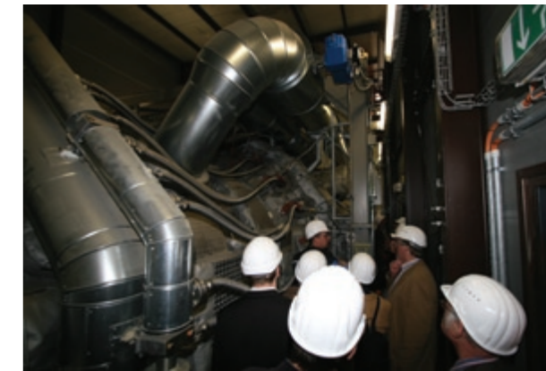
Gas- und Dampfturbinenkraftwerk in Hamm-Uentrop
