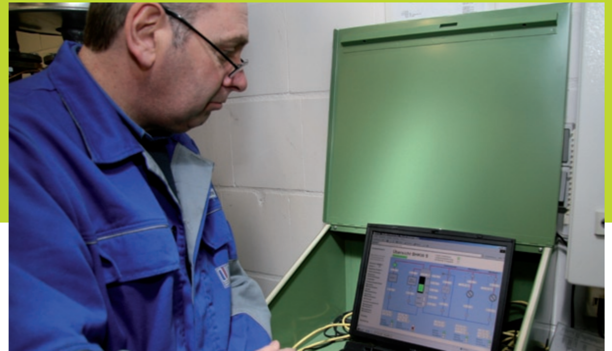
Intelligente Steuerung dezentraler Erzeugungsanlagen: Hier im BHKW 5.
