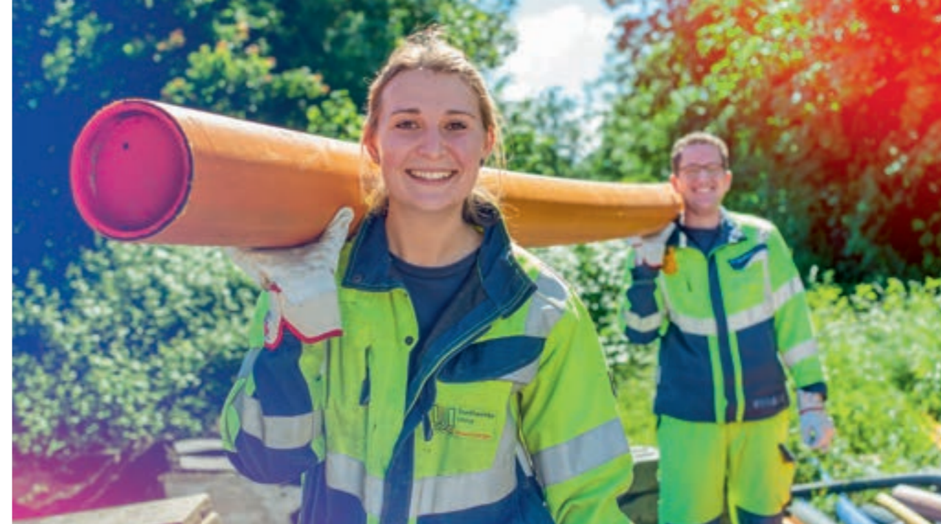
Kontinuierlich investieren wir in das sichere Netz und schaffen damit Versorgungssicherheit für Unna.
