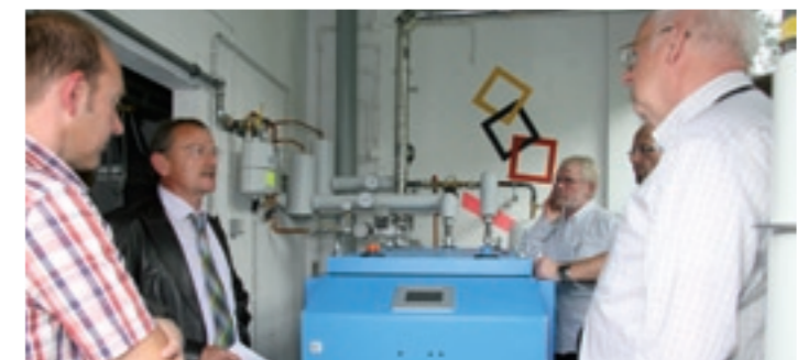
Blockheizkraftwerk im Massener Hellweg-Bad.
