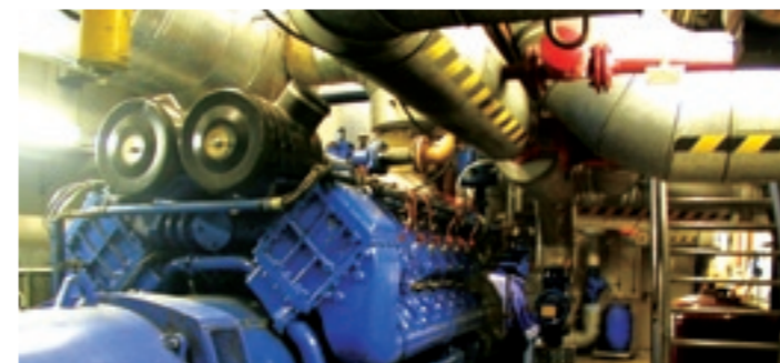
Blockheizkraftwerk 1 in der Gartenvorstadt.
