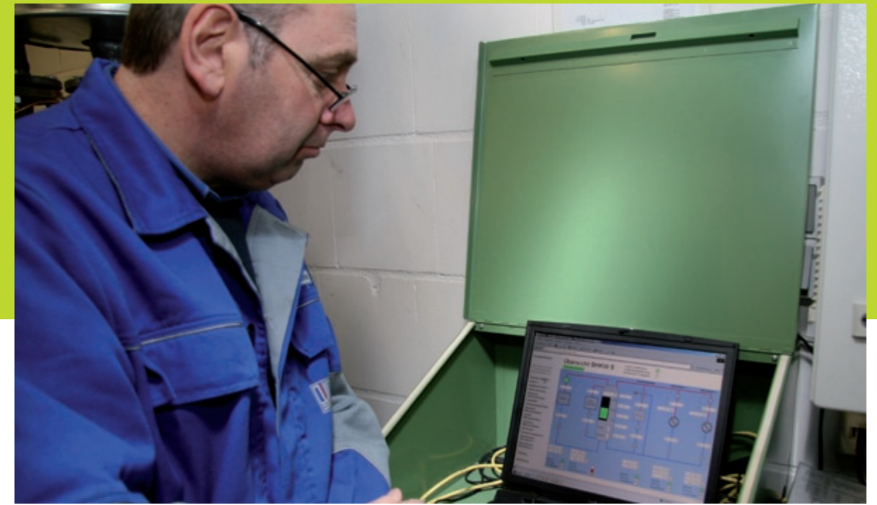
Intelligente Steuerung dezentraler Erzeugungsanlagen: Hier im BHKW 5.
