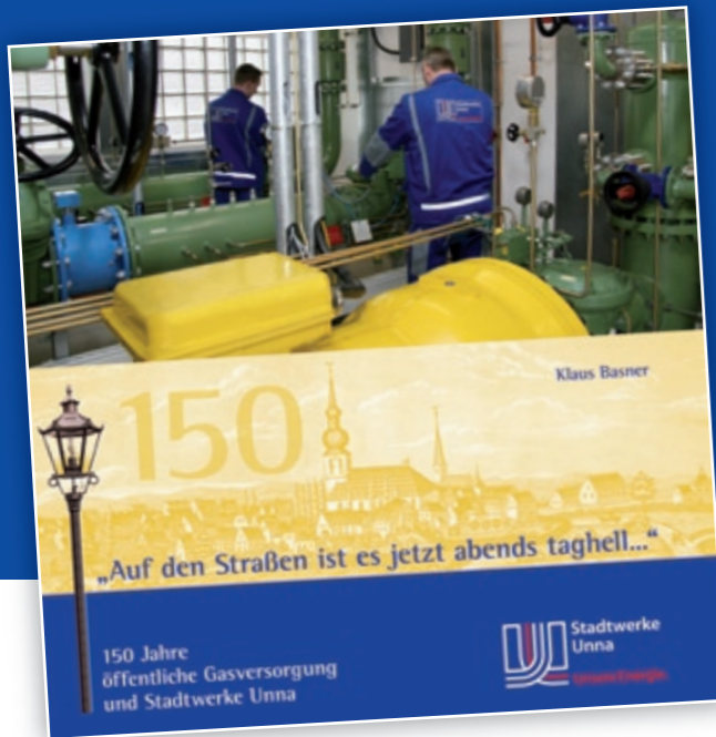
Erfahrung hat Zukunft. In diesem Jahr konnten die Stadtwerke Unna schon den 150. Geburtstag des Unternehmens feiern. Das Bild zeigt über der historischen Stadtkulisse unsere Gasübernahmestation an der Schlegelstraße.
