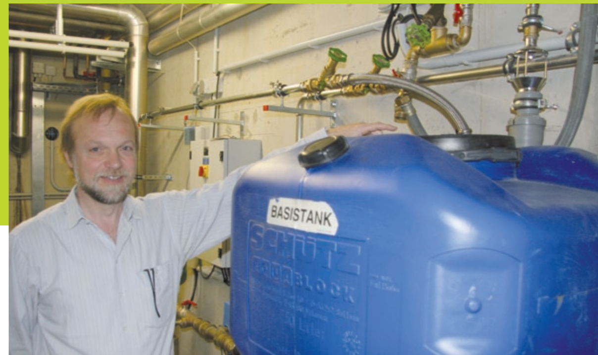
Die Regenwasseranlage in unserer Firmenzentrale spart Frischwasser ein.
