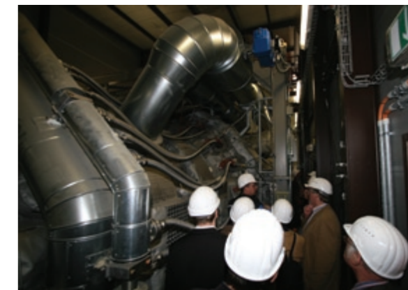
Gas- und Dampfturbinenkraftwerk in Hamm-Uentrop
