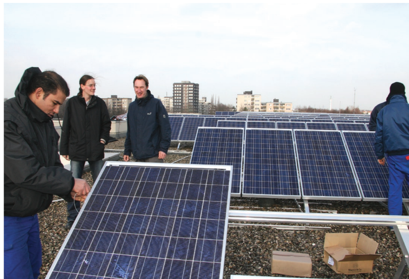
Wir machen Schulzentren zu Solarfarmen: Auf den Königsborner Schulen haben die Stadtwerke Fotovoltaik-Anlagen installiert.
